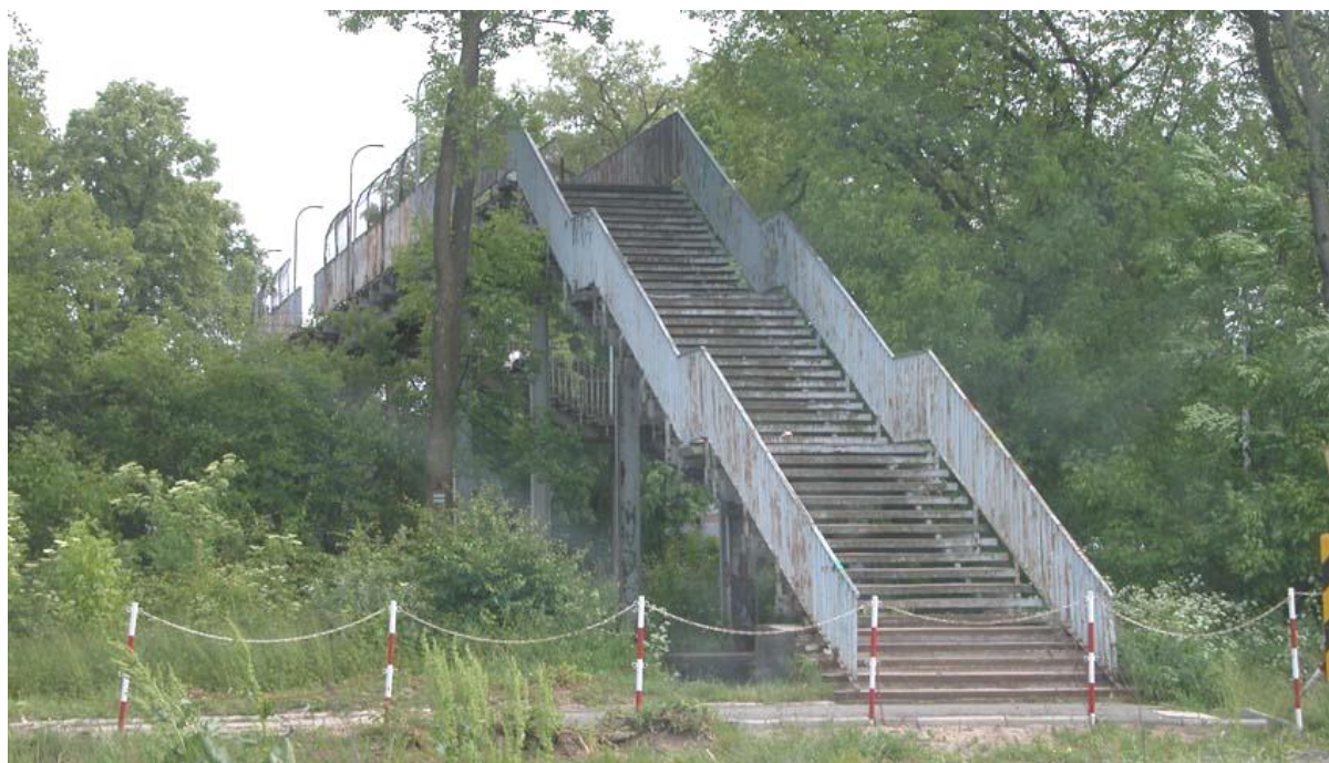
fot. 9 Przejście nad torami w centrum miasta - widok od strony Stefanina.
