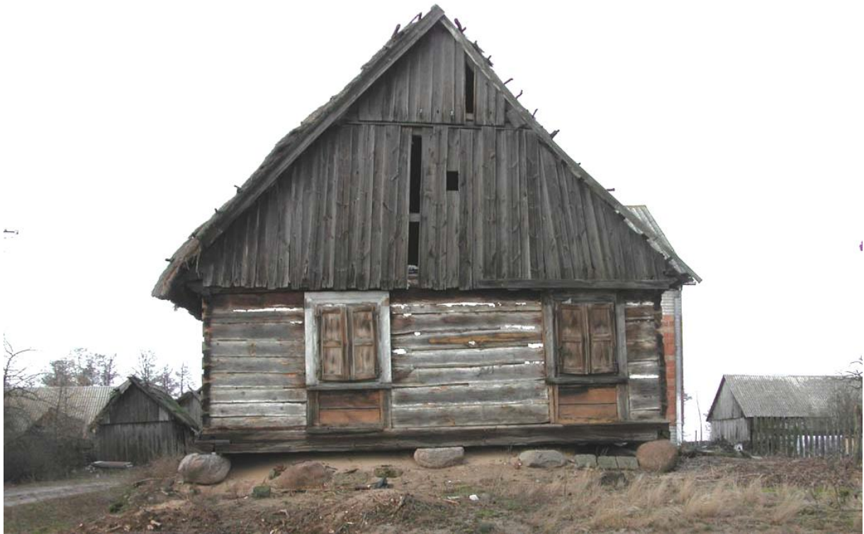
fot. 50 Brzuza - najstarszy dom drewniany konstrukcji zrębowej wpisany do rejestru zabytków, widok od szczytu – stan z listopada 2004 roku, zburzony latem 2005 r.
