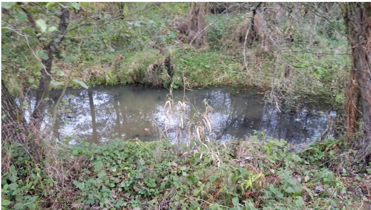
Zdjęcie 69. Zamulony kanał równoległy do Liwca
