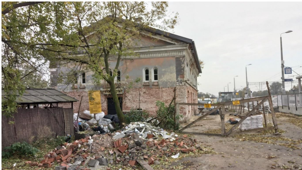
Zdjęcie 6. Hałda odpadów budowlanych przy budynku dworca z widokiem na czynny peron
