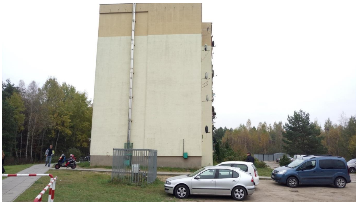
Zdjęcie 41. Elewacja budynku i komin kotłowni olejowej, parking przy budynku i barierka
