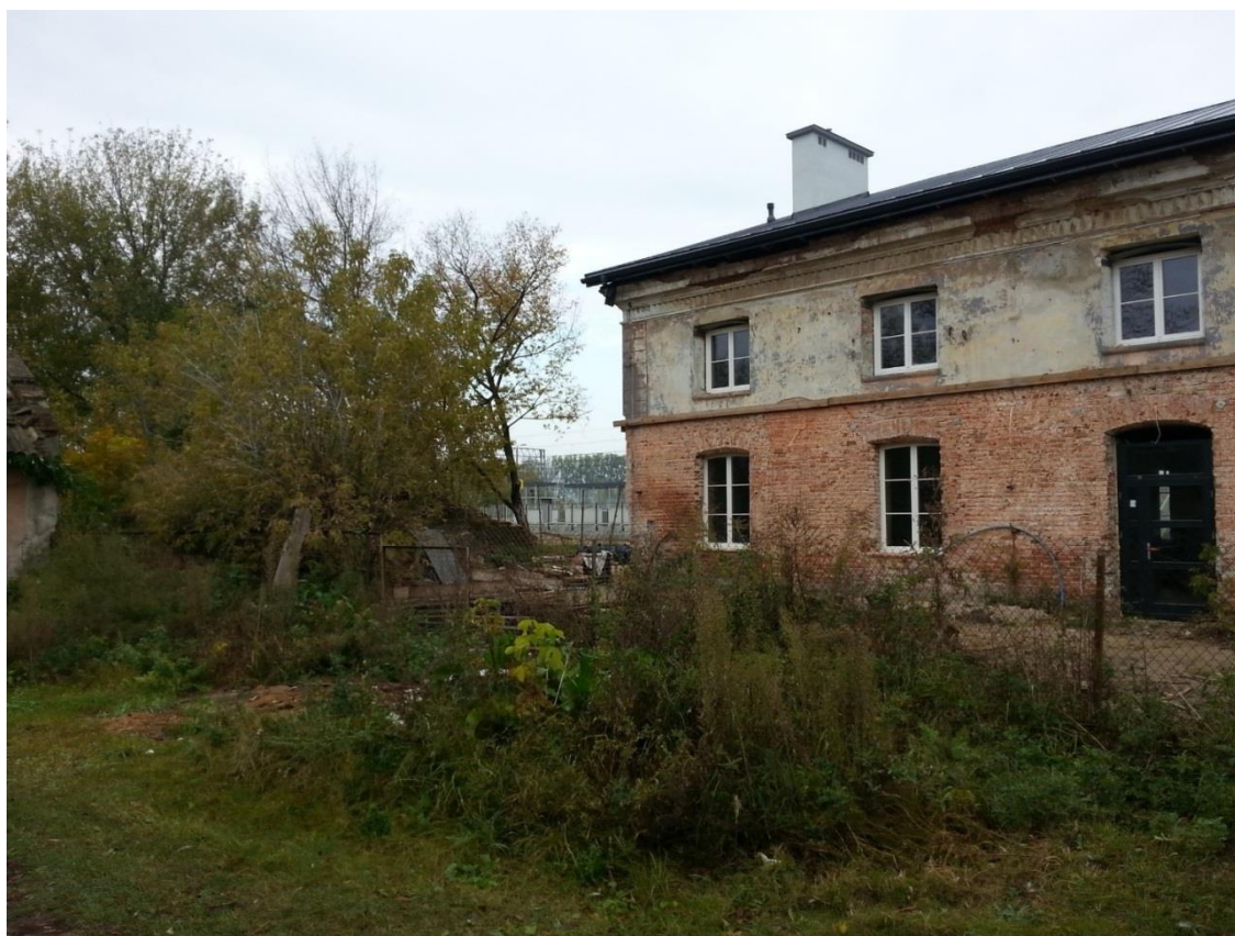
Zdjęcie 5. Zaniedbana elewacja budynku dworcowego
