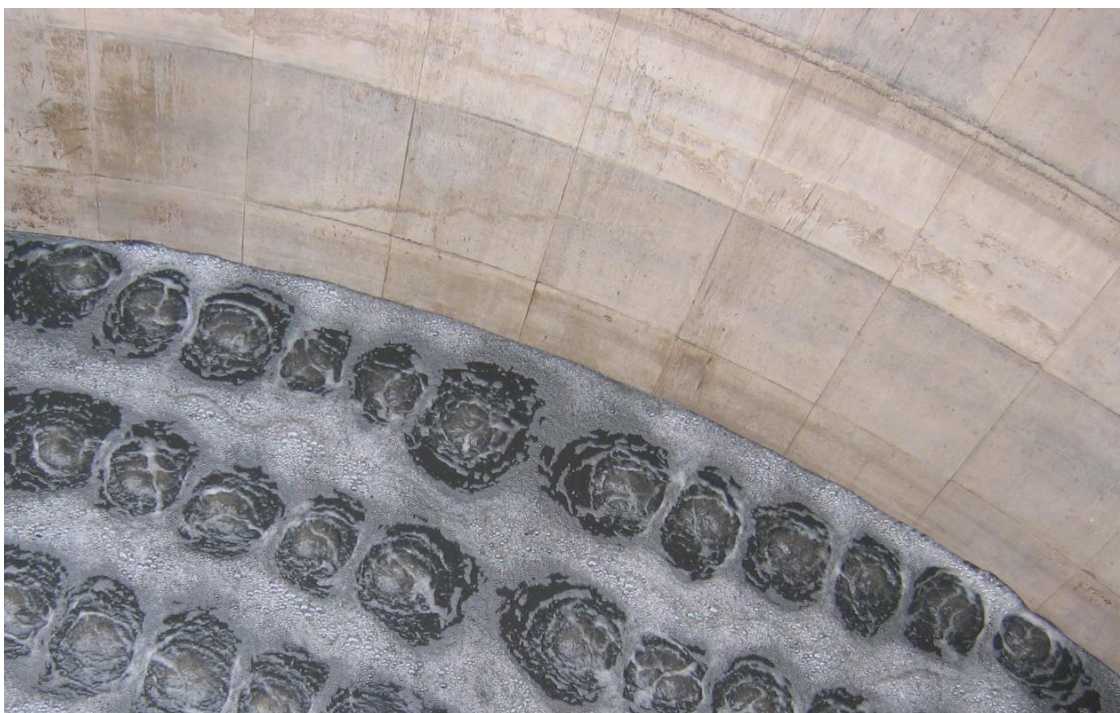
Fot. 5.4. Napowietrzanie ścieków w komorze bezciśnieniowej (otwartej) - widok przy napełnianiu reaktora (źródło: J.Mech, SZGK Łochów)
